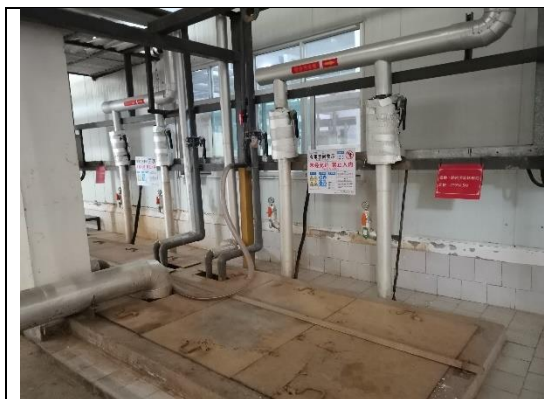
污水处理站综合污泥转移池
