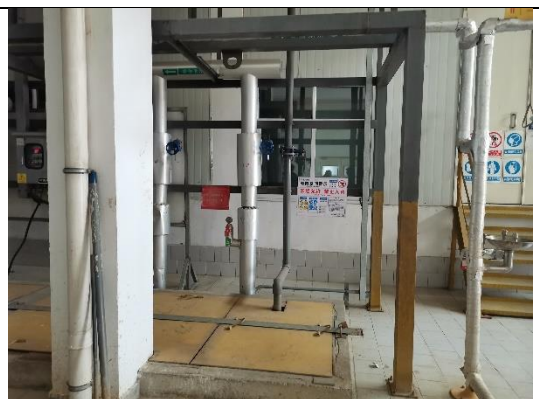
污水处理站物化集水池
