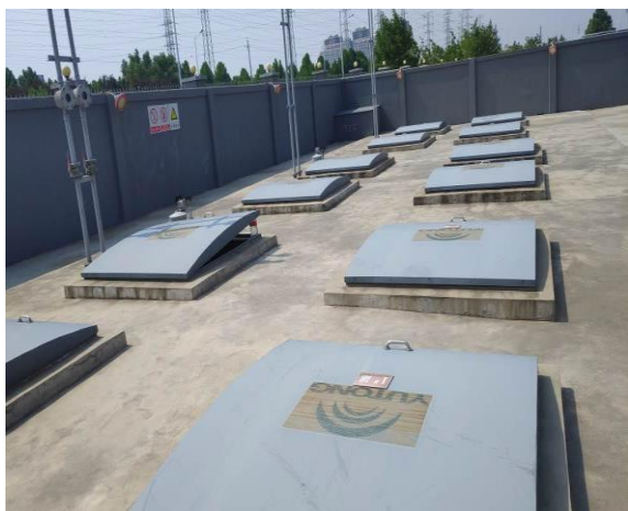
加油站地下储罐
